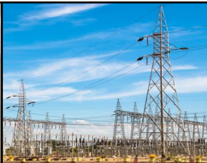
Projek-Projek Sistem Rangkaian Elektrik
